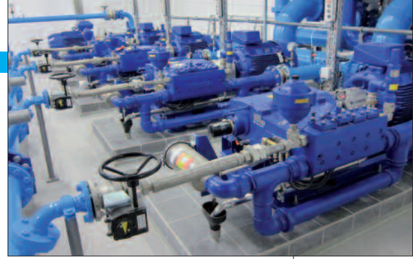
Modernes Pumpwerk mit Hochdruck-Pumpenaggregaten für die Trinkwasserversorgung
