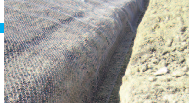
SGS Biberschutz entlang der March
