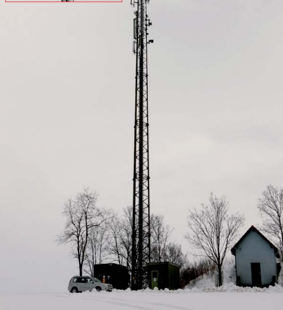
Die erste Mobilfunkbasisstation mit Windturbine von mobilkom austria in Eibesthal bei Mistelbach
