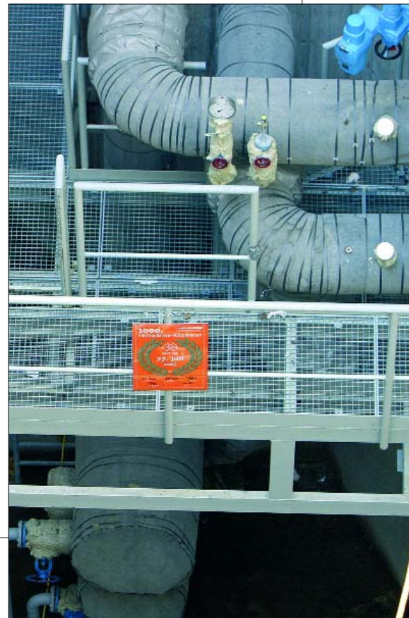
DN 600 Haupttransportleitungen mit DN 250 Abzweigleitungen
